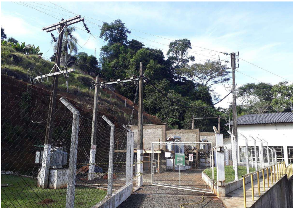
Foto 15. Subestação, conduto forçado e casa de força
