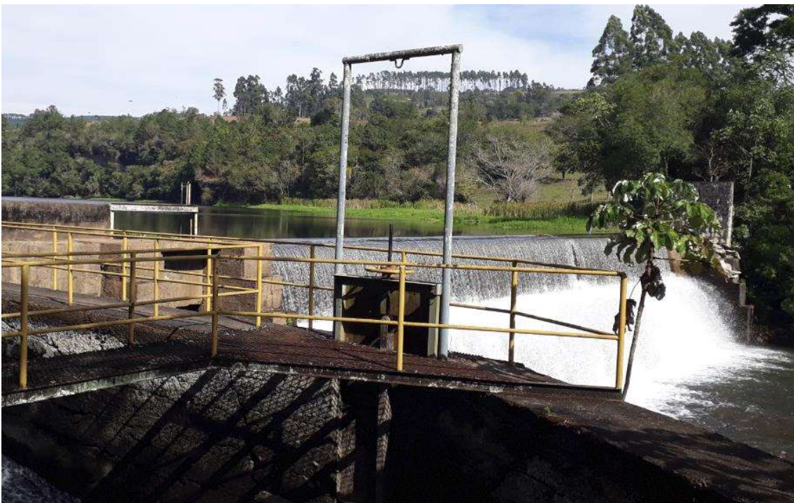
Foto 8. Desarenador do canal de adução: válvula da comporta e canal de escoamento
