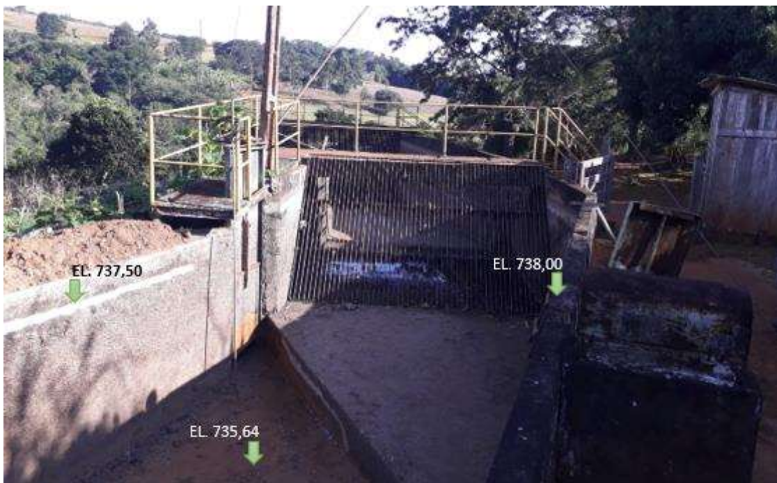
Foto 13. Câmara de carga e vertedouro lateral
