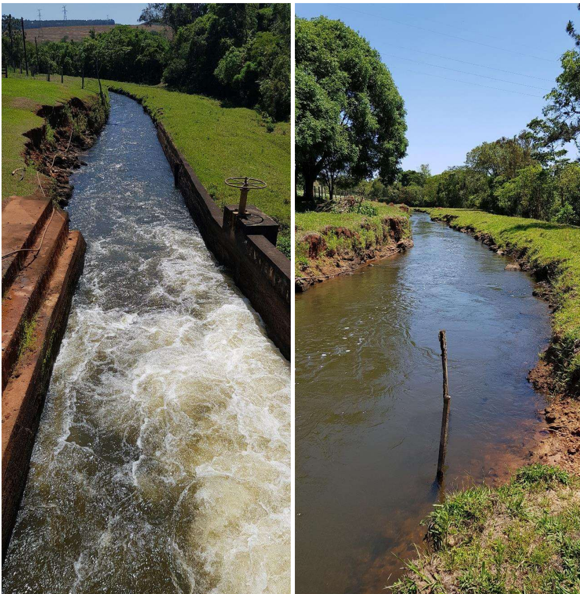
Foto 8. Canal de adução: trecho inicial revestido em concreto, seguido de trecho escavado em solo e rocha
