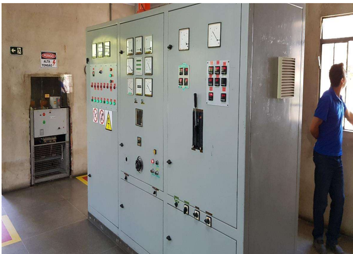
Foto 16. Piso superior da casa de força – painel elétrico
